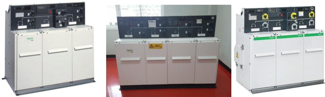
ภาพที่ 2 ชุดอุปกรณ์สวิตซ์ไฟฟ้า รিংเมนยูนิท (RMU)
