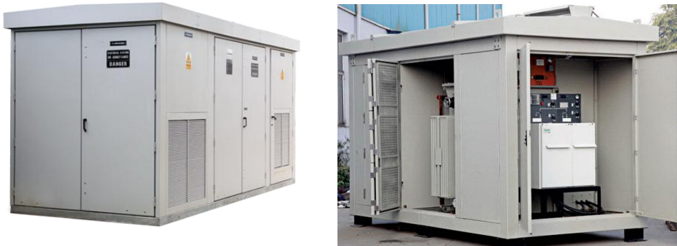
ภาพที่ 4 ชุดอุปกรณ์สวิตซ์ไฟฟ้า ยูนิตซับสเตชัน (Unit-Substation)
