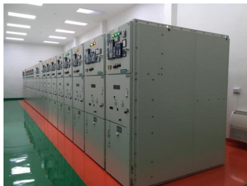
ภาพที่ 10 ชุดอุปกรณ์สวิตซ์เกียร์ไฟฟ้า (Switch gear)
